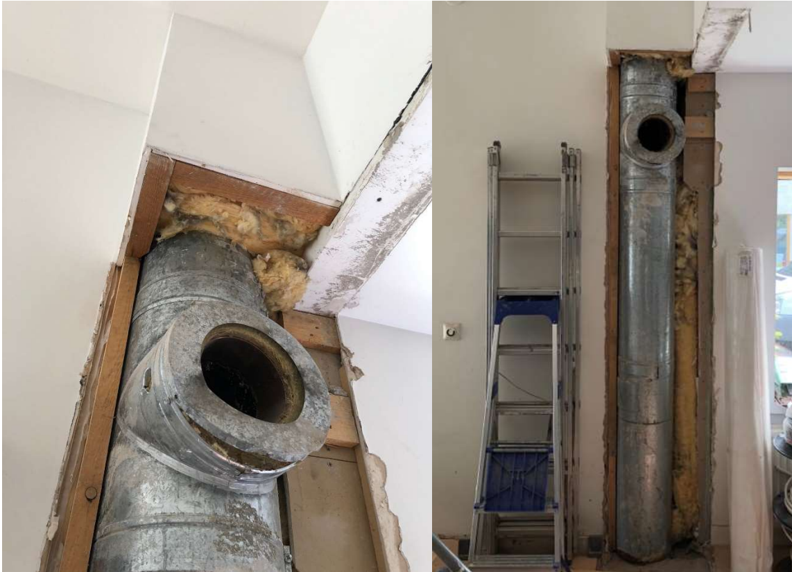
Kuva 1. Paikalla metallista rakennettu savupiipun virheellinen kotelointi.
