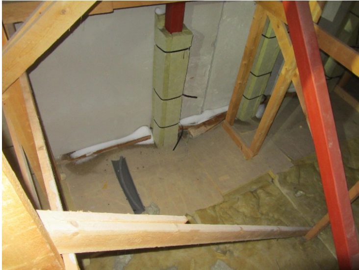
Kuva 4. Lunta yläpohjan tuuletustilassa lämmöneristeen päällä. Kuva on toisesta rakennuksesta.
