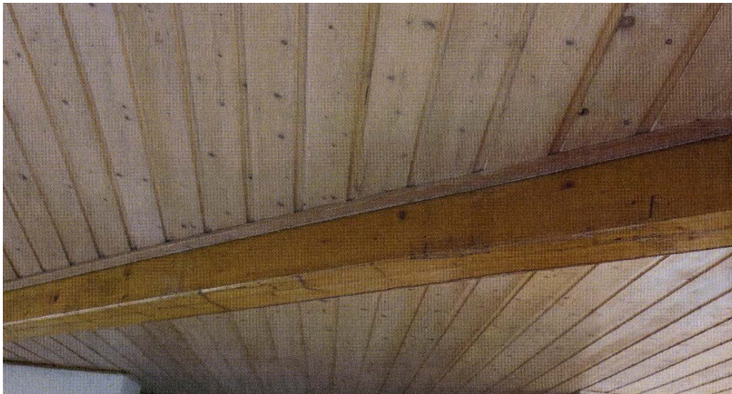
Kuva 1. Lumen sulattua vedeksi se on kulkeutunut jiirin kohdalle ja aiheuttanut vuotojälkiä.
